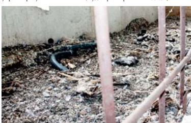
Даже через решётку виден помёт, лежащий на балконе многоквартирного дома
