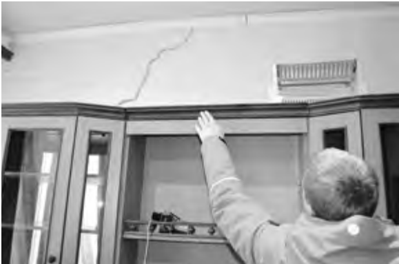
Трещина в квартире Фёдора Чаплицкого
