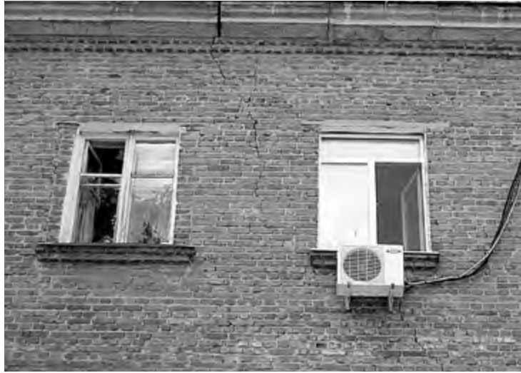
С обоих торцов дом треснул. Жильцы боятся, что он развалится
